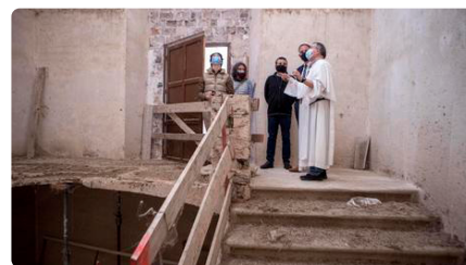
Sant Ramon demana a l'Estat 300.000 € per reparar les cobertes del santuari DV, 9/10/2020 | SEGRE
